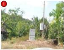
1 Kabinet telekom yang terletak di persimpangan jalan masuk ke Universiti Teknologi Mara (UITM) Bukit Besi
