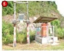
5 Pencawang elektrik di Jalan Jerangau - Jabor
