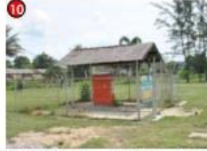
10 Pencawang elektrik yang terletak di Jalan Permata
