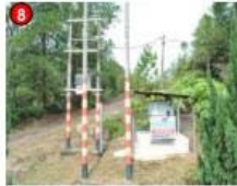
8 Pencawang elektrik di persimpangan jalan masuk ke Padang Golf Tasik Puteri
