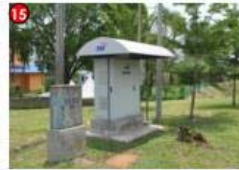
15 Kabinet telekom berhampiran dengan dewan
