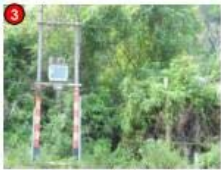
3 Pencawang elektrik di jalan Kg Besol Lama
