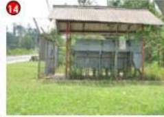
14 Pencawang elektrik terletak di antara persimpangan Jalan Permata dan Jalan Emas
