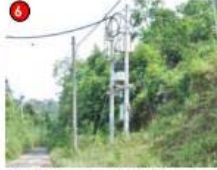
6 Pencawang elektrik terletak di jalan dalam Kg Talang
